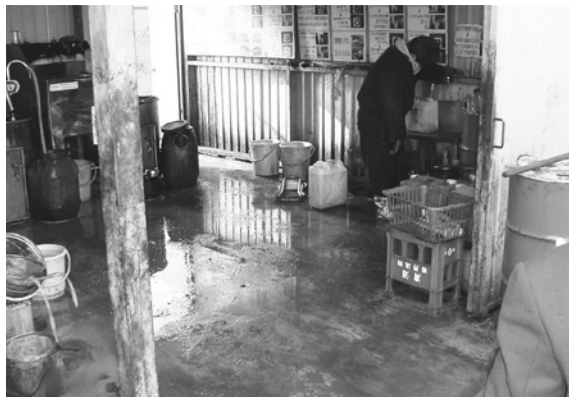
廃食用油からエコ軽油を製造するプラント。回収や販売を通して地域との連携を深め、環境ビジネスとしても高く評価されています。
